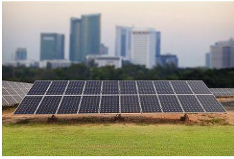
Painéis solares fotovoltaicos
